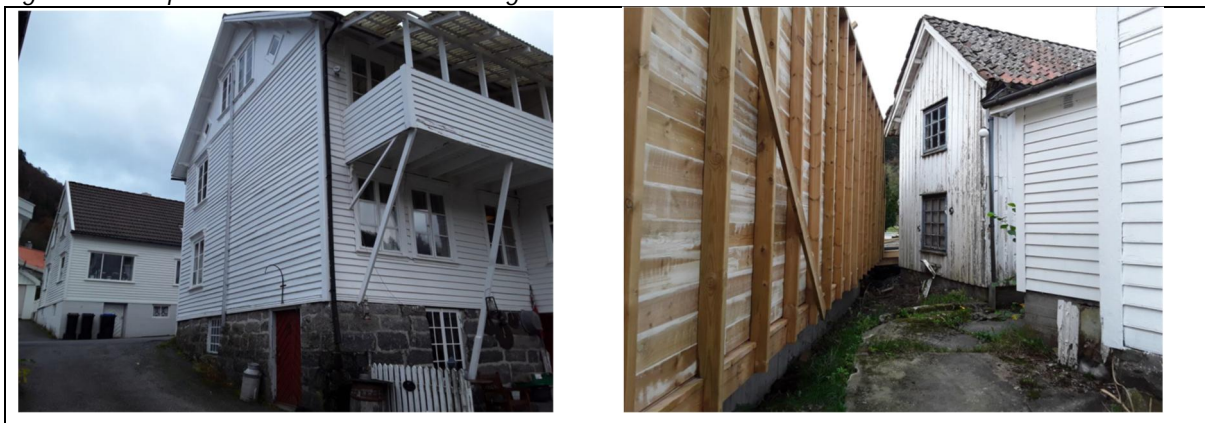
Figur 17 Eksempler som er brannteknisk uheldige.
